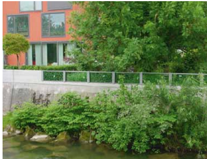
Hochwasserschutzwand mit Sicherheitsglas
